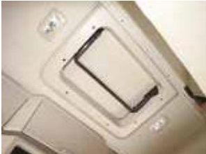
Ventilación de Techo
